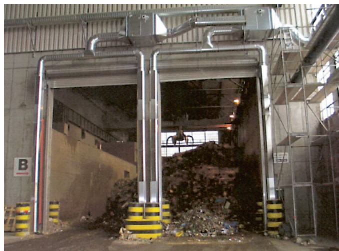
Industrielle Anwendung in Abfallverarbeitungsbetrieb. LKW's können ein- und ausfahren, zum Entladen in der Toröffnung stehen bleiben und trotzdem dringt keine Zugluft ein und kein Geruch und Staub verlässt den Raum.
